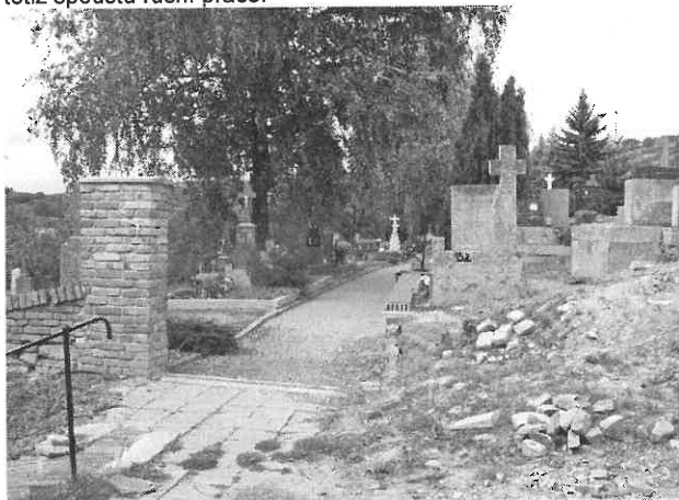
Oprava brány by měla být provedena ještě letos
